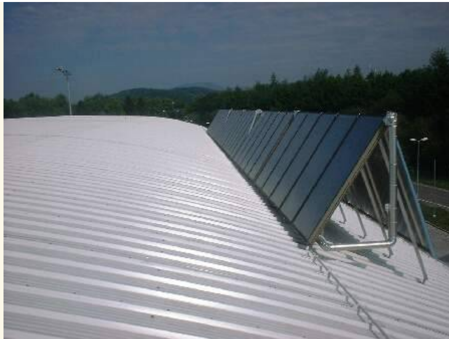
Obr. 5: Solární kolektor s úhlem sklonu \sim 60^\circ postavený na konstrukci na střeše fotbalového stadionu
