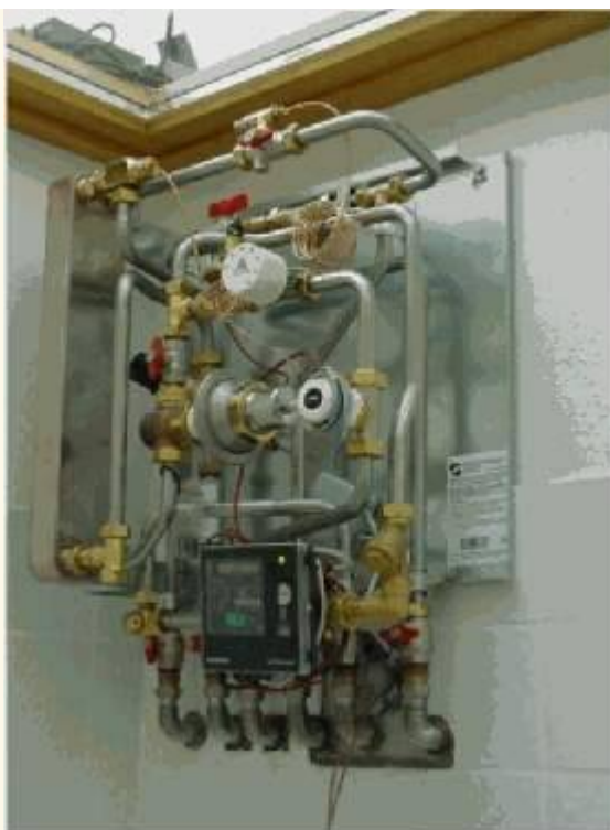
Obr. 10: Příkladná ukážka bytové stanice s tepelným výměníkem, regulačními prvky a měřičem tepla
