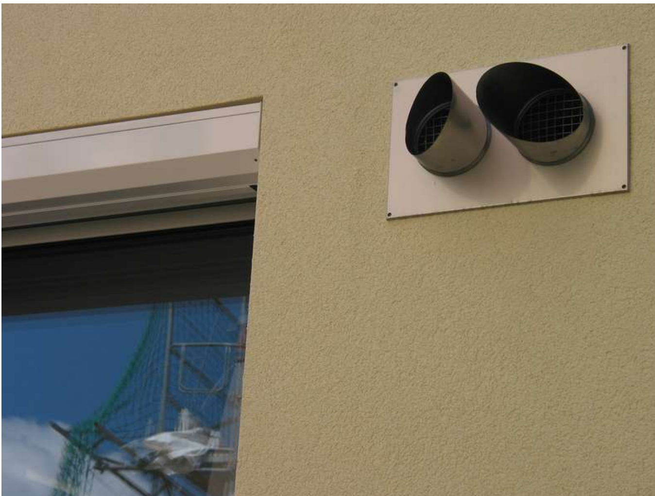
Nasávání čerstvého vzduchu a výfuk odpadního vzduchu na fasádě, venkovní žaluzie
